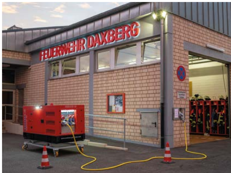
Notstrom einspeisung des Feuergerätehauses bei dem großflächiger Stromausfall im Juli 2025 im Landkreis Aschaffenburg
