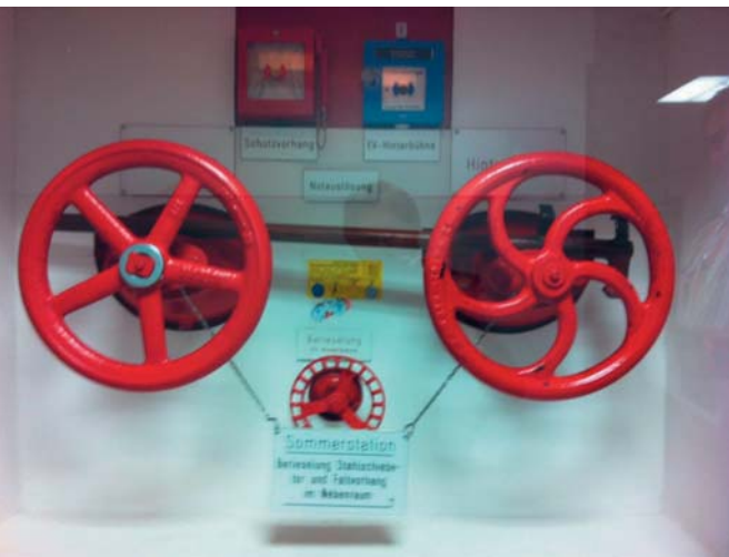
Löscheinrichtungen im Keller des Festspielhauses.
